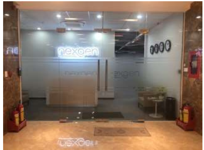
Hạng mục: Thi công Lắp đặt văn phòng mới công ty NEXGEN
