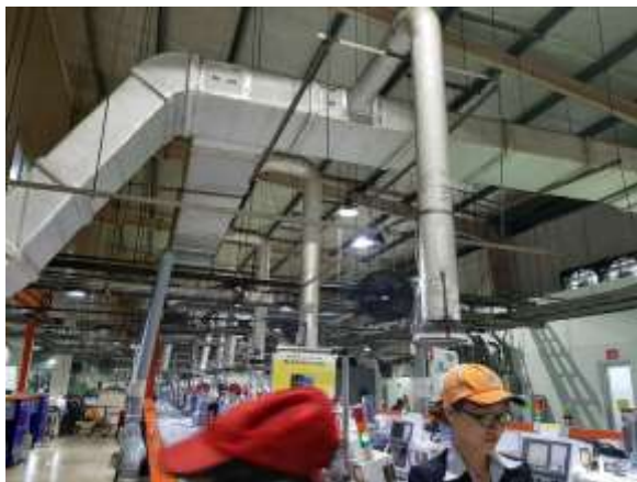
Hạng mục: Thi công lắp đặt hệ thống lạnh ống gió công ty Maruei
