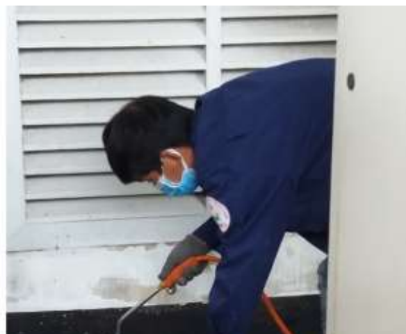
Hạng mục: Thi công chống thấm sàn máy AHU công ty DKSH
