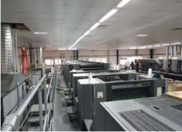
Hạng mục: Lắp đặt hệ thống chiller giải nhiệt cho máy in offset công ty Alliance
